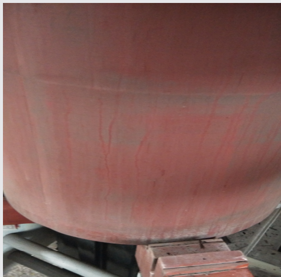
现场变压器表面凝露污秽图片
